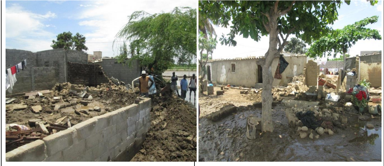
Figura 2.11 e 2.12 Exemplo do grau de devastação no Bairro do Tchipiandalo causadas pela inundação do Cavaco
