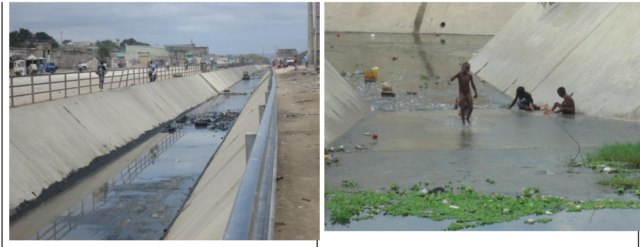
Figura 2.24 e 2.25 Contaminação na vala de drenagem do Coringe e uso para recreio.
