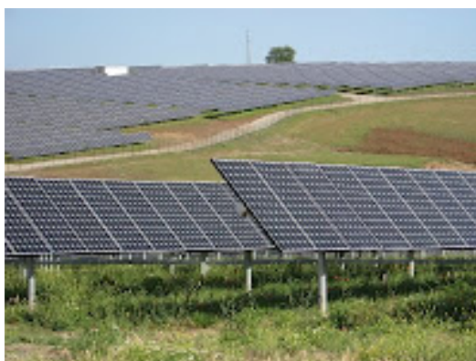
Figura 1.8 - Central Fotovoltaica de Hércules
